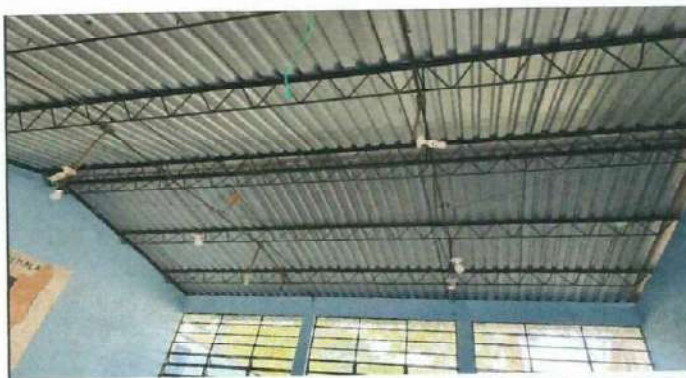
Foto 4: Se observa deterioro de bombillas, plafoneras, cables, en los modulos No. 1, 2 y 3.
