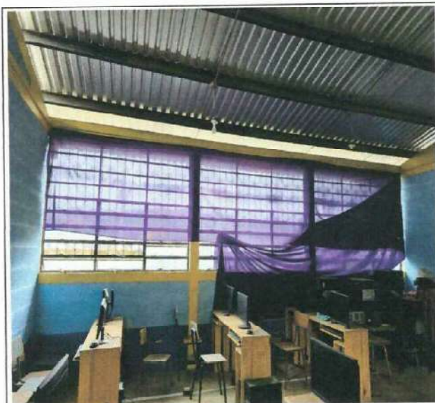
Foto 7: Se observa que no se cuenta cortineras en los módulos 1, 2 y 3
