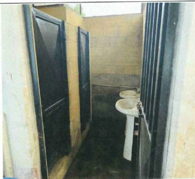
Foto 8: se observa deterioro de lavamanos e inodoro
